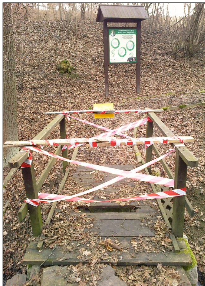
Po zakończeniu projektu zabrakło chętnych i pieniędzy na utrzymanie i remont mostku w Parku Abym w Kudowie Zdroju
